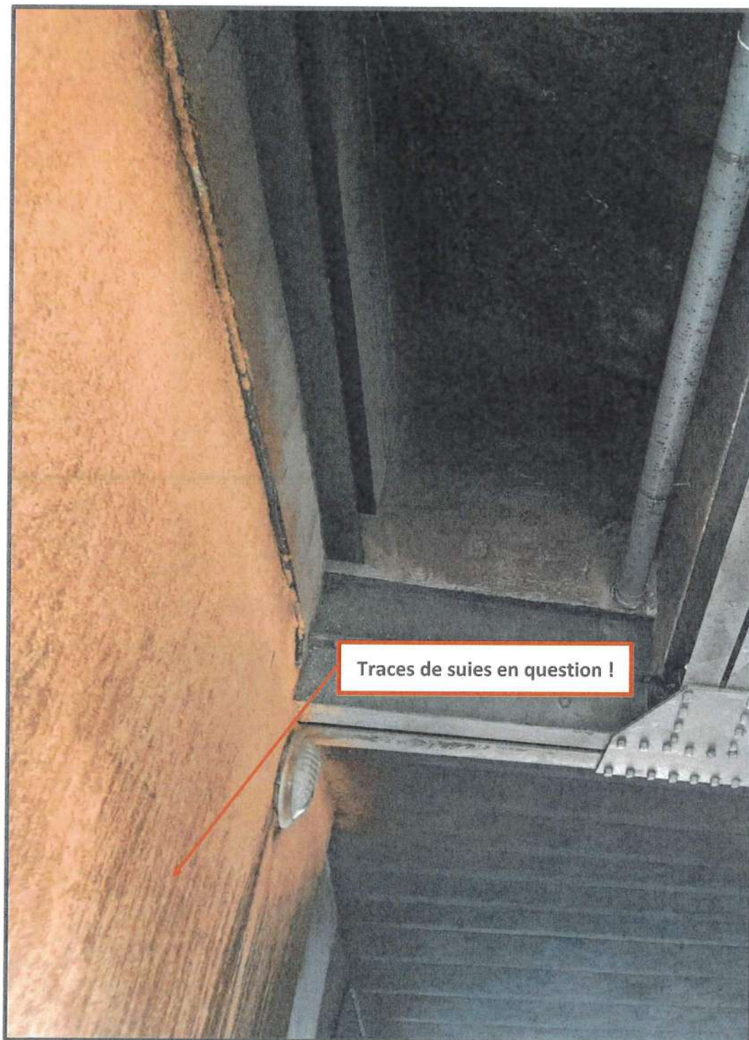
Figure 8 : Mur voisin à nettoyer de la suie qui le recouvre
