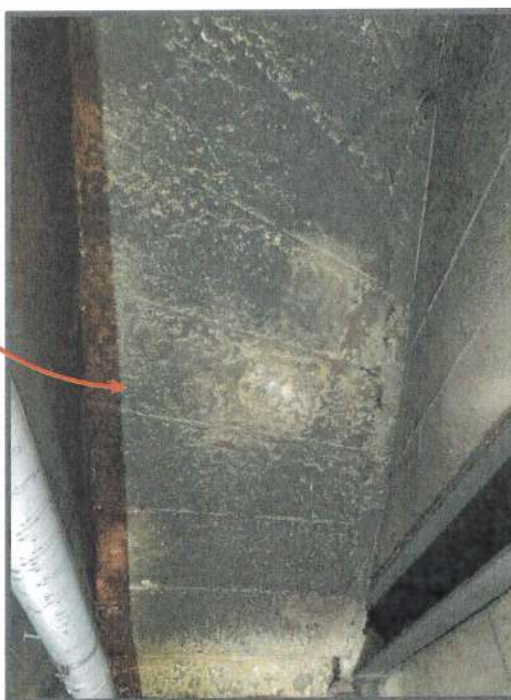
Figure 13 : Sous-face de la volée d'escalier voisine à nettoyer
