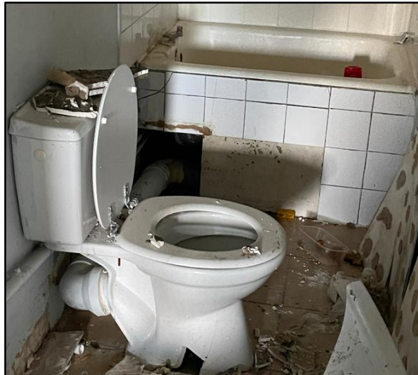
Exemple de salle de bains dégradée
