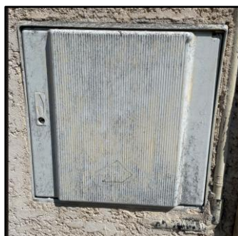
Coffret gaz encastré d'un logement de l'étage
