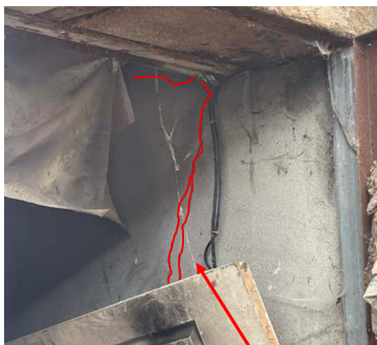
Présence d'une fissure verticale.
