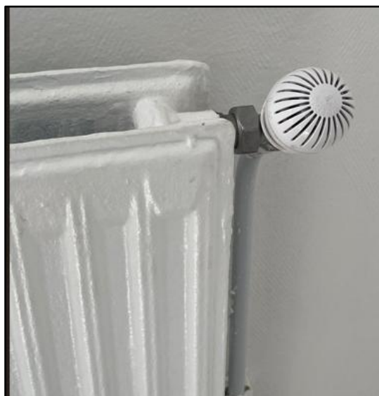
Radiateur acier équipé d'un robinet simple
