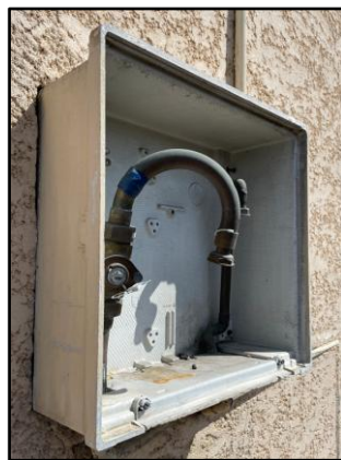
Coffret gaz saillie d'un logement de l'étage
