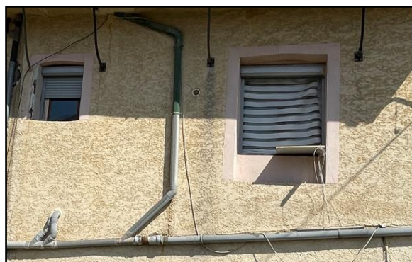
Collecteurs EU-EV en façade arrière
