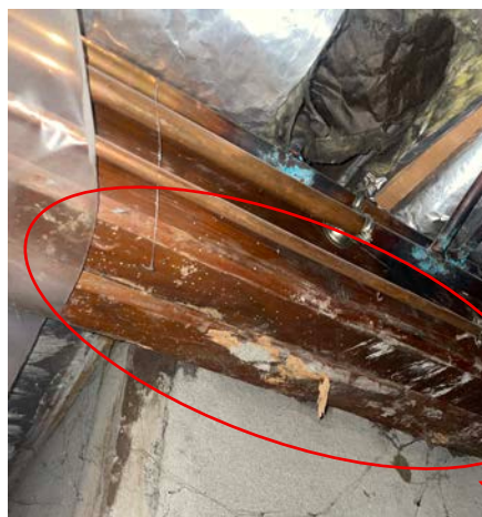
Bois de poutre présentant des dégradations à cause de l'humidité et des insectes lignivores.
