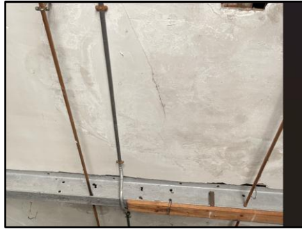
Réseaux de plomberie en plafond d'un garage non calorifugé
