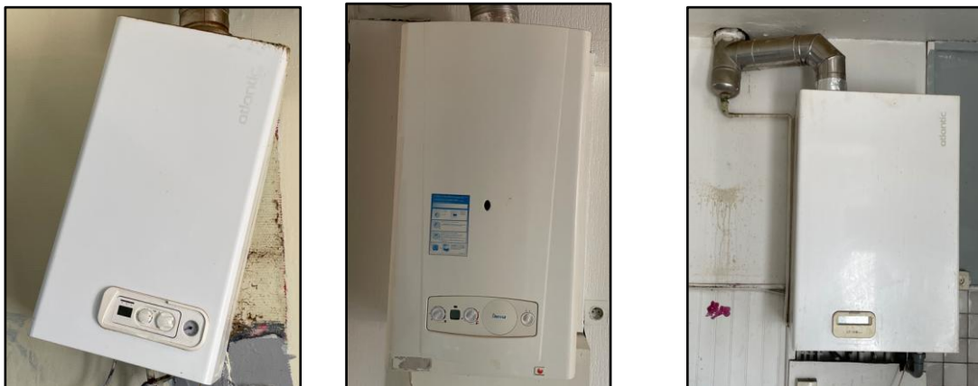
Chaudières des 3 logement du R+1
