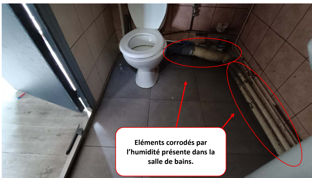
Figure 42 : Etat des lieux – photo de la salle de bains de l'appartement numéro 5
