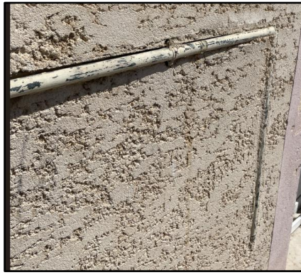
Réseau gaz semi encastré dans le crépis de façade
